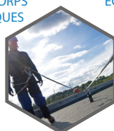
LIGNE DE VIE
